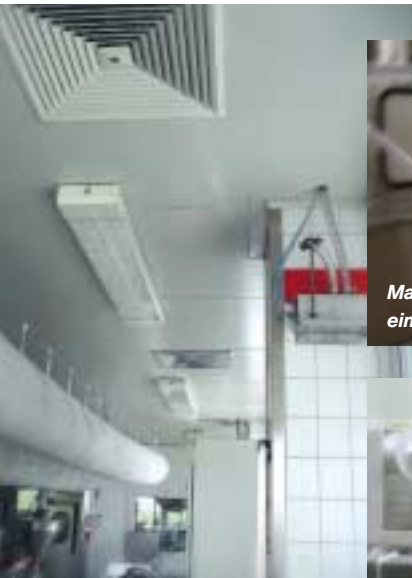
Raumlufthygiene- modul in der Frischkäseabfüllung
