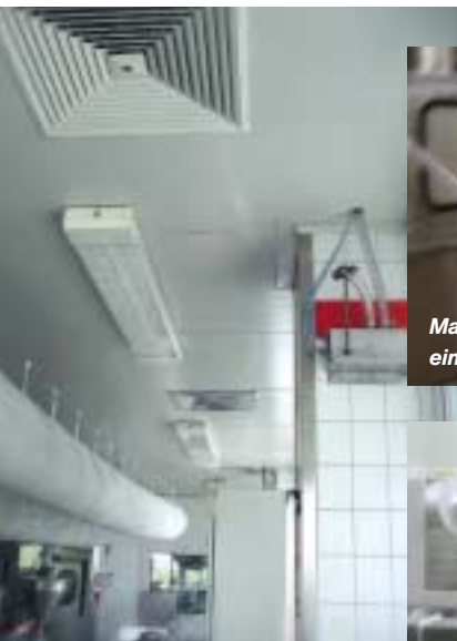
Raumlufthygiene- modul in der Frischkäseabfüllung
