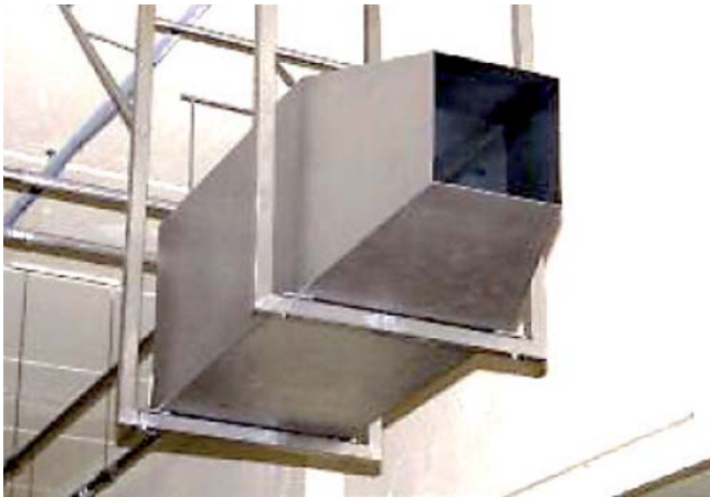
Transport- lüfter zur Luftoptimierung.
