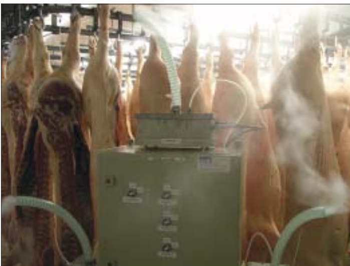
Luftbefeuchtung und Entkeimung im Schlachtkühlhaus
