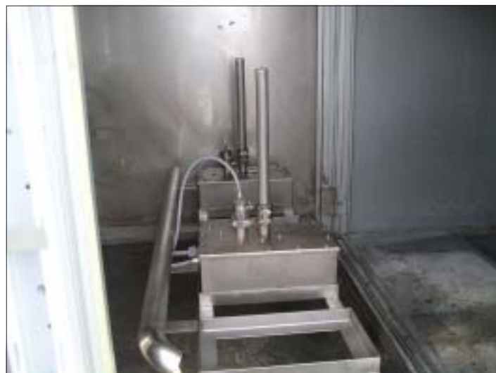
Entkeimungsstation im Zuluftsystem
