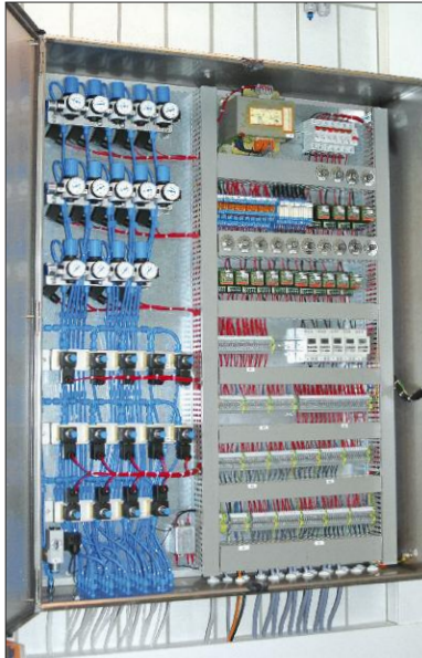
Schaltschrank für die zentrale Steuerung der einzelnen Verneblungsgeräte
